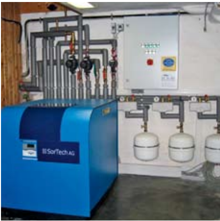
Anlage mit Sorptionskältemaschine im Blumenhaus Bade, Henstedt-Ulzburg
